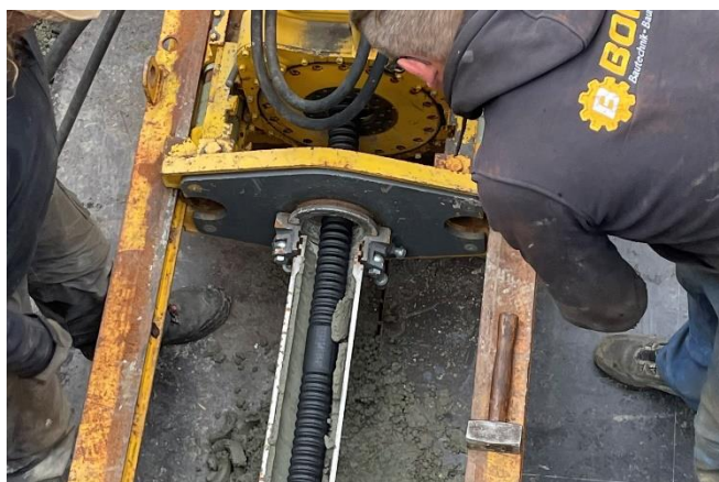
Abb. 3 GeoHoP: Mittels horizontal oder schräg eingeführter Geothermie-sonden kann im Bestandsquartier unter Gebäuden Wärme gewonnen werden.
